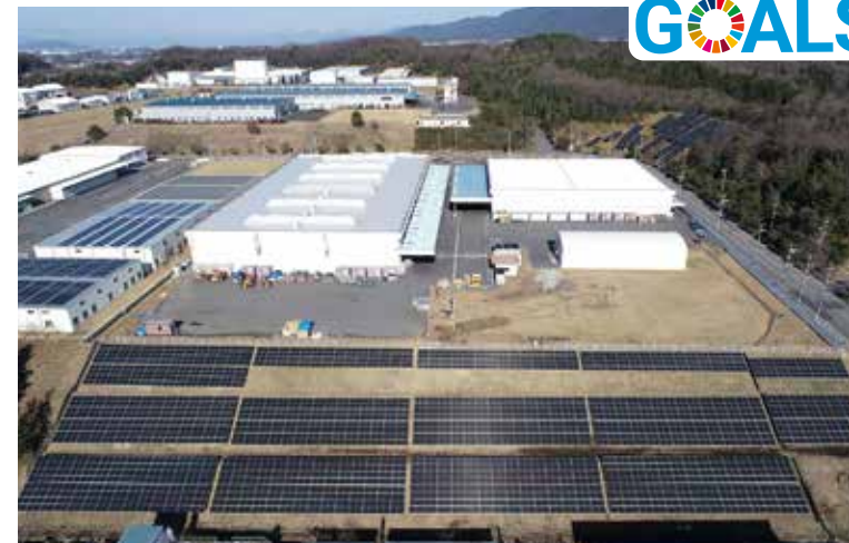
▲滋賀工場に設置された太陽光発電設備
